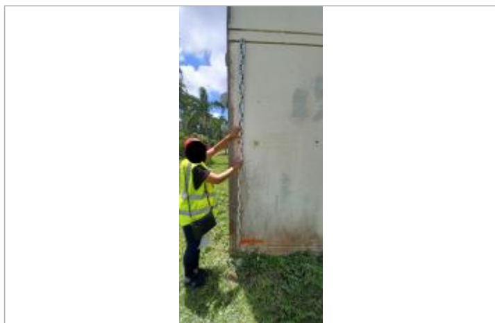
Dépôts de matières solides
