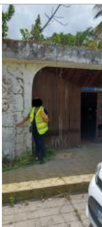
Dépôts de matières solides
