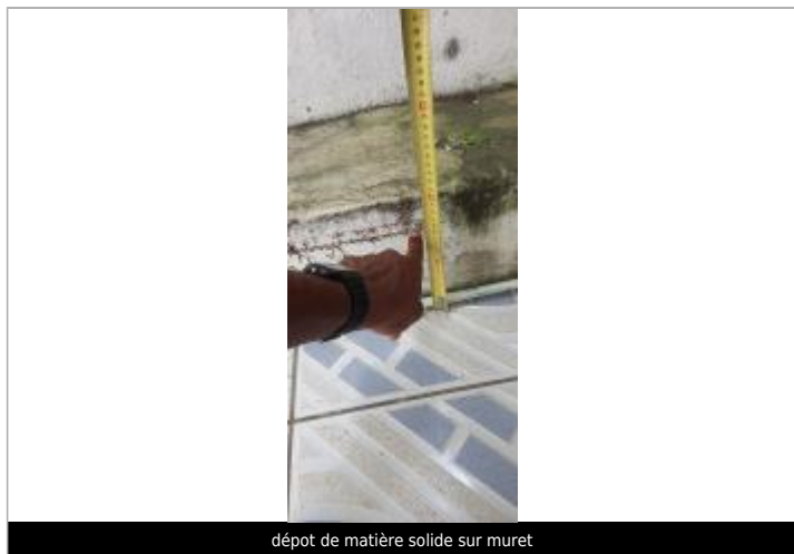
dépot de matière solide sur muret
