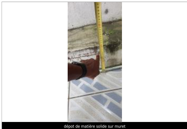
dépot de matière solide sur muret
