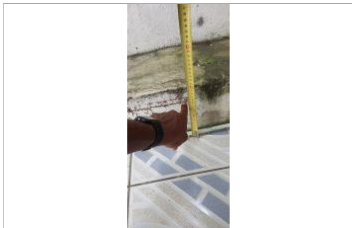
dépôt de matière solide sur muret
