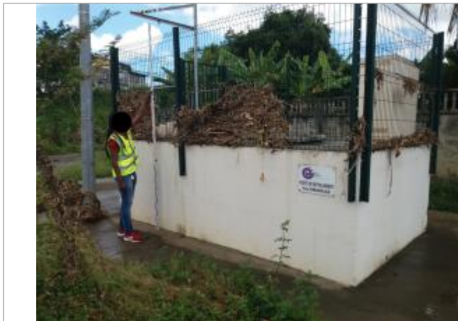
Poste de refoulement et dépôts sur grillage
