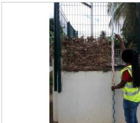
Dépôts de matières solides
