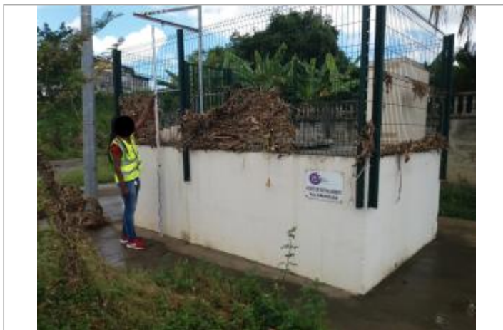
Poste de refoulement et dépôts sur grillage
