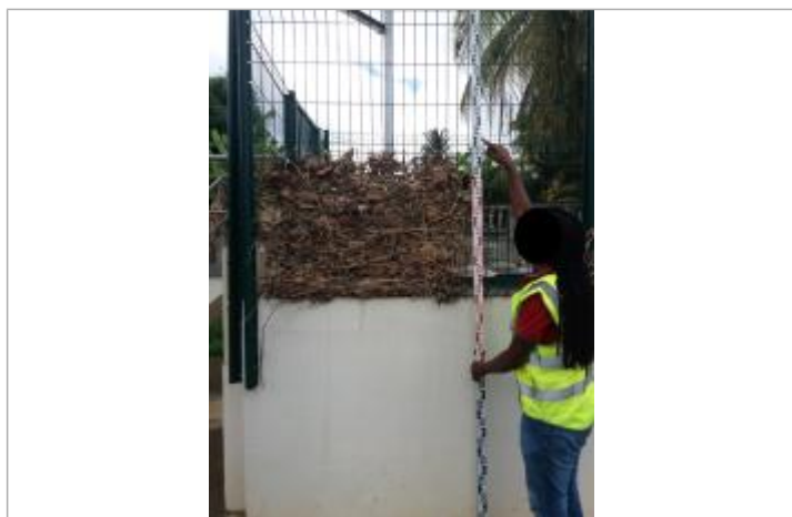
Dépôts de matières solides
