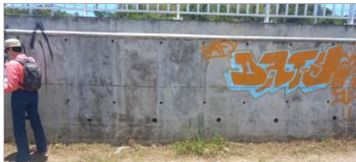
Dépôts matières solides
