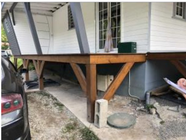
Dépôts de matières solides
