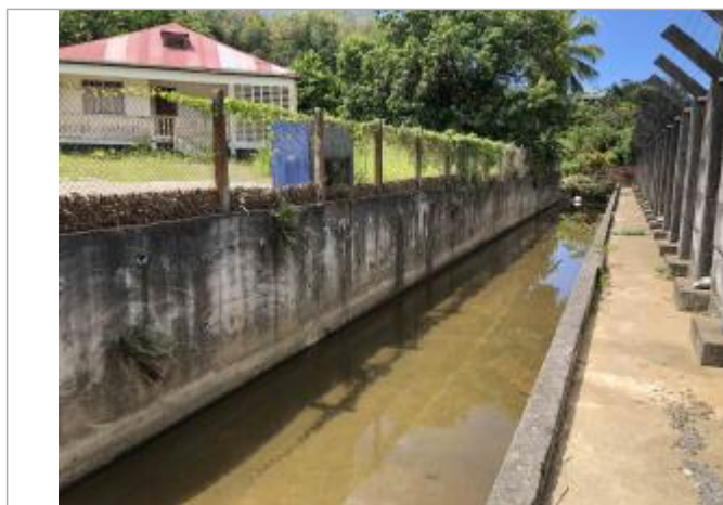
Dépôts de matières solides sur le grillage
