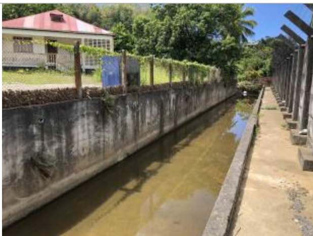
Dépôts de matières solides sur le grillage
