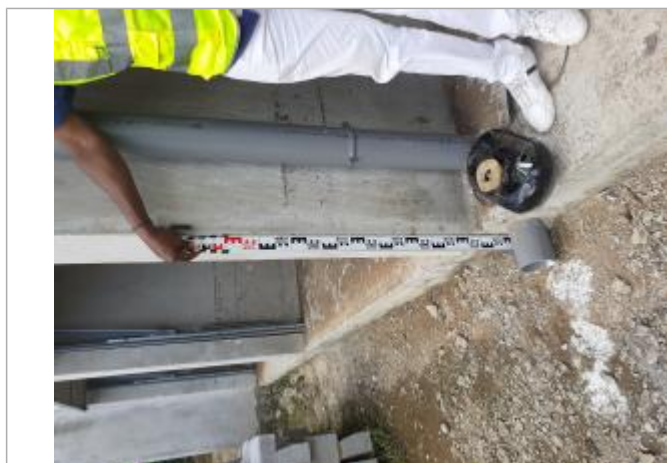
Dépôts de matières solides
