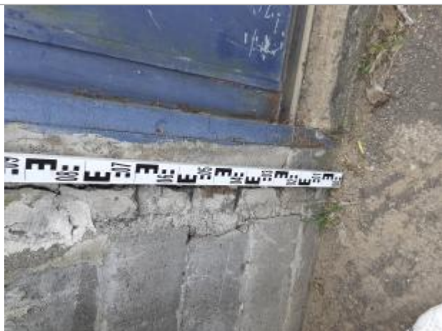
Dépôts de matières solides
