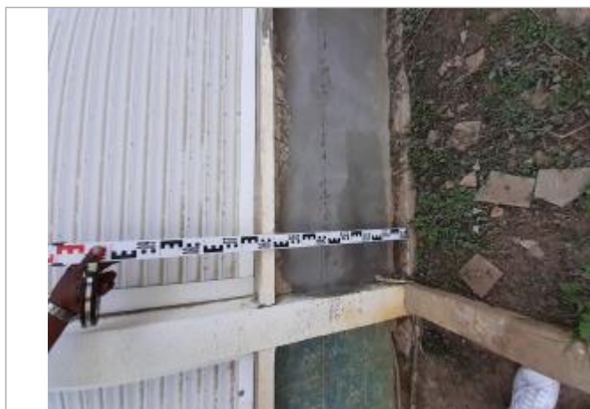
Dépôts de matières solides
