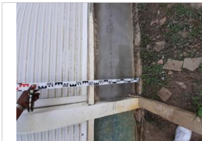
Dépôts de matières solides
