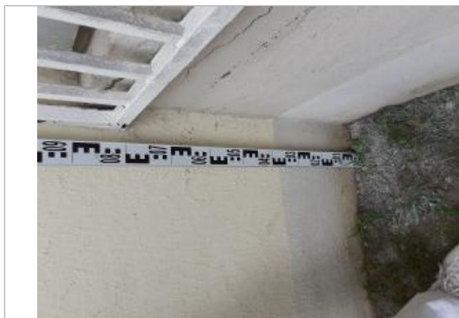
Dépôts de matières solides
