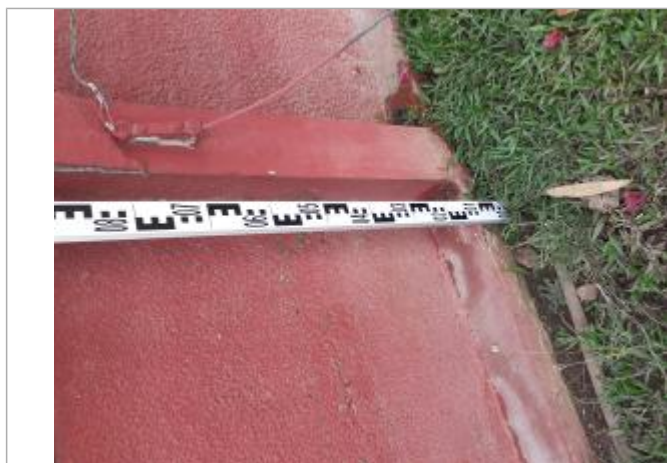
Dépôts de matières solides
