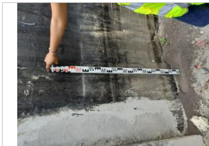
Dépôts de matières solides
