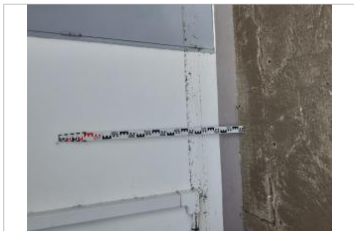
Dépôts de matières solides
