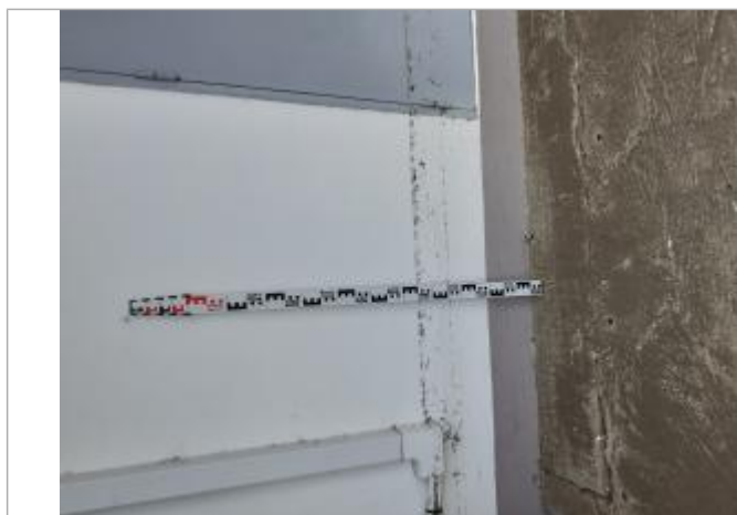
Dépôts de matières solides
