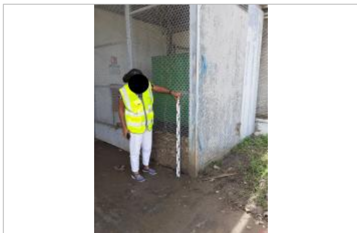
Dépôts de matières solides
