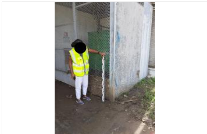
Dépôts de matières solides
