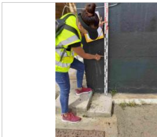
Dépôts de matières solides
