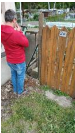
Laisse de crue sur le mur à 10 cm/ sol
