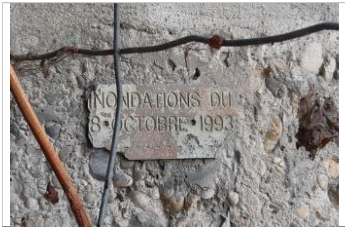
Vue du repère (plaque métallique abîmée)
