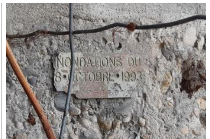
Vue du repère (plaque métallique abîmée)
