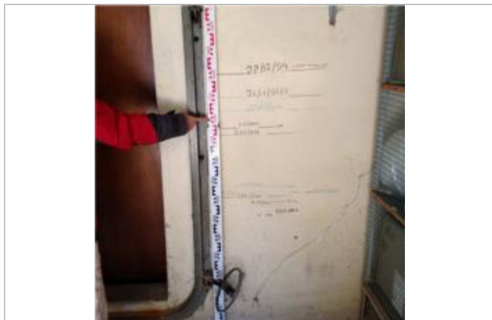
Marque sur le mur
