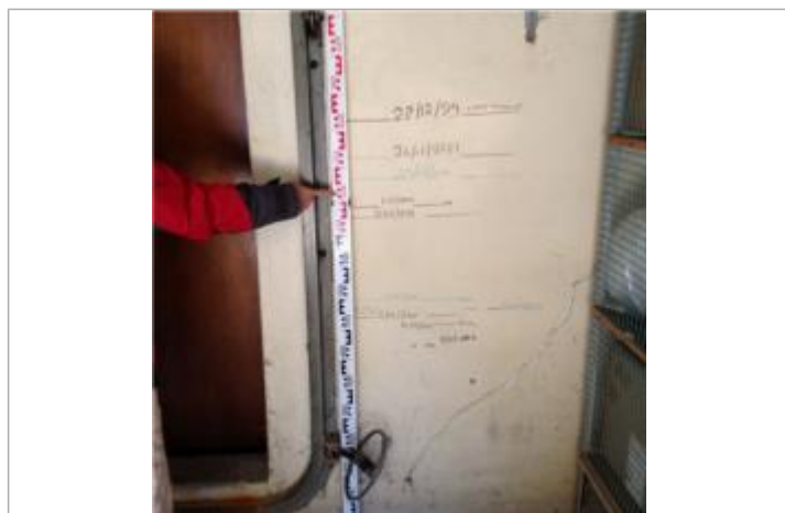
Marque sur le mur
