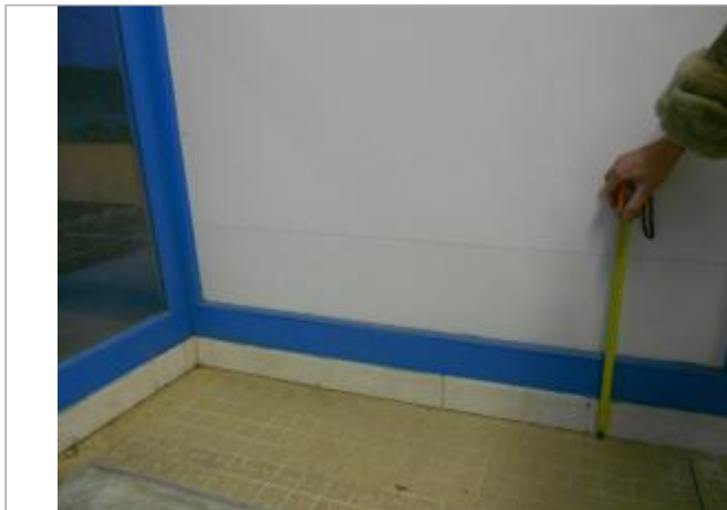
Marque du niveau d'eau dans le sas d'accueil
