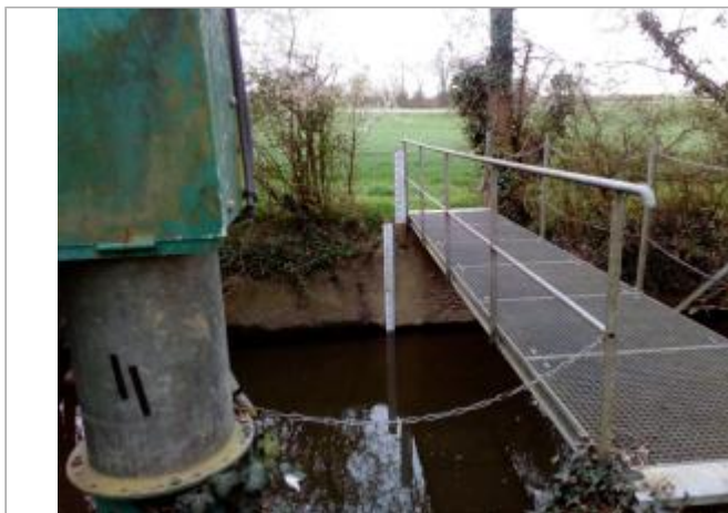
Station limnimétrique de l'Aron à Grand-Fougeray
