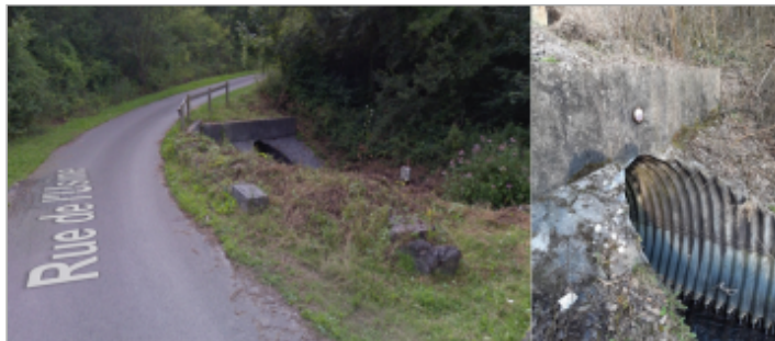
Ouvrage busé entre la rue du pont et la rue de l'usine ( ruisseau le crembreux)
