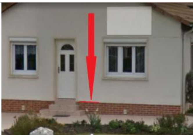
L'eau est arrivée au niveau du haut du muret de briques sur la façade de la maison.
