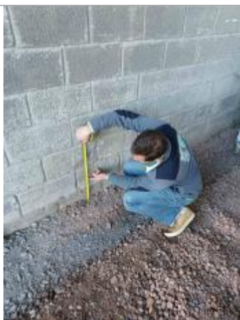
Laisse de crue sur le mur de parpaings
