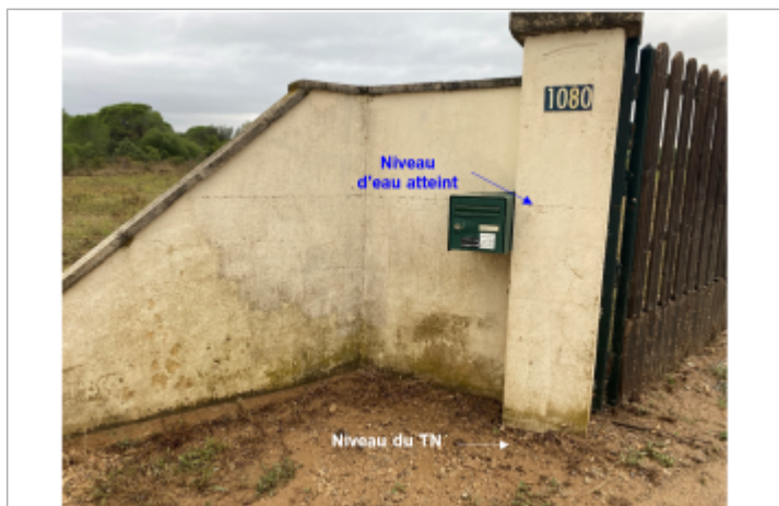
Niveau d'eau bien marqué sur le mur d'enceinte de la propriété privée
