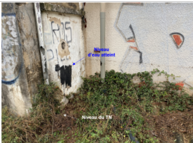
Niveau d'eau bien marqué sur le mur du bâtiment
