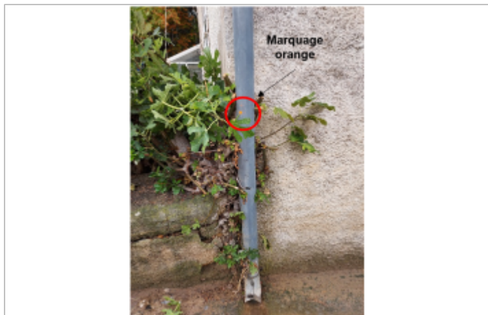
Niveau d'eau bien marqué sur la maison puis projeté sur la descente de gouttière
