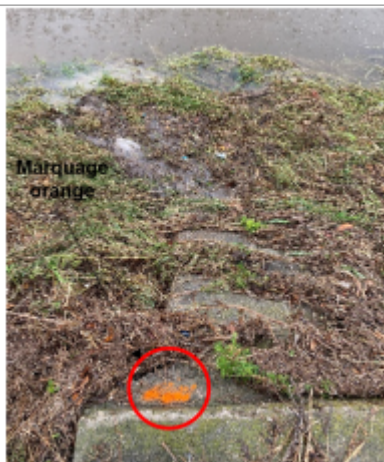
Trace bien visible au niveau de la berge
