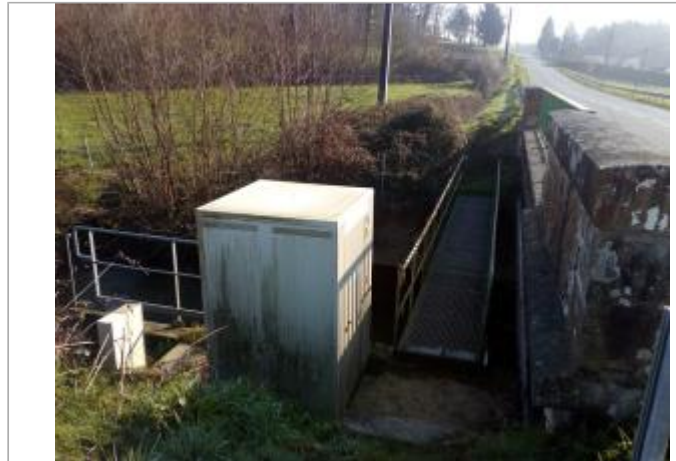
Station limnimétrique du Néal à Médréac sous le pont de la RD 220
