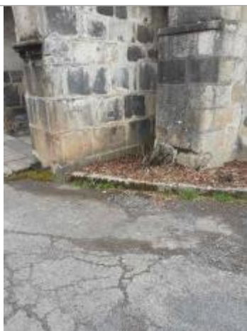
45 cm d'eau mesuré à l'entrée de l'église
