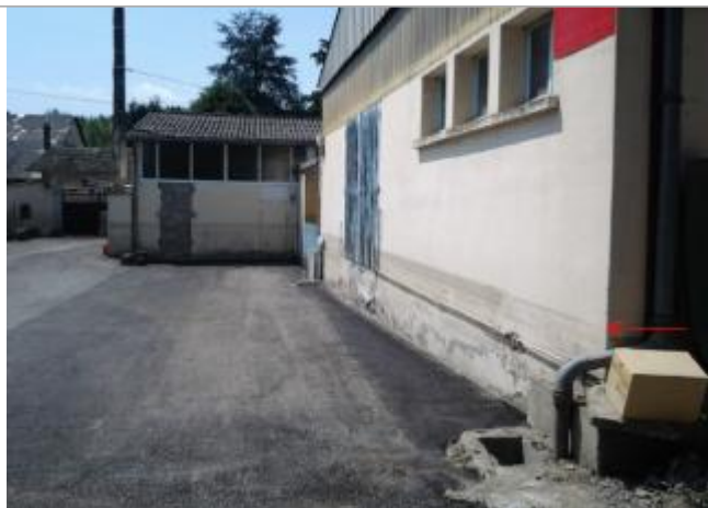
Vue du repère (la flèche rouge représente le niveau atteint par les eaux) - Auteur : HEA/DDTM 64
