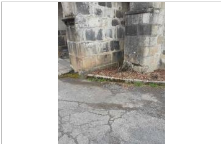
45 cm d'eau mesuré à l'entrée de l'église
