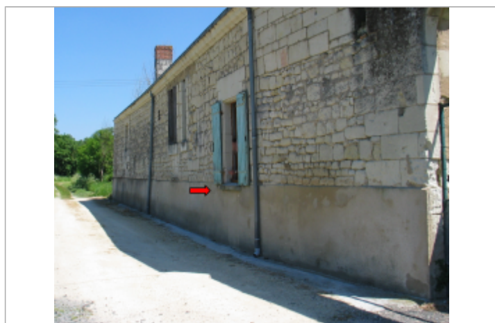
Eau au ras de l'appui de fenetre
