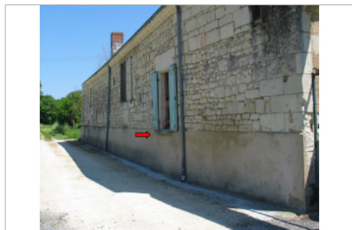
Eau au ras de l'appui de fenetre
