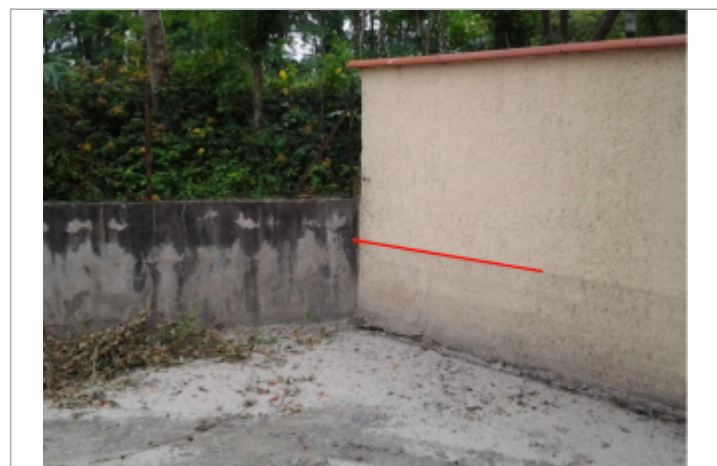
Vue du repère (le trait rouge représente le niveau atteint par les eaux) - Auteur : HEA/DDTM 64
