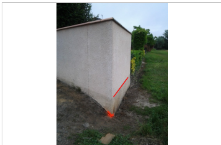
Vue du repère (le trait rouge représente le niveau atteint par les eaux) - Auteur : HEA/DDTM 64
