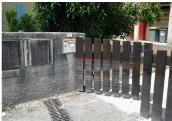
Vue du repère (le trait rouge représente le niveau atteint par les eaux) - Auteur : HEA/DDTM 64
