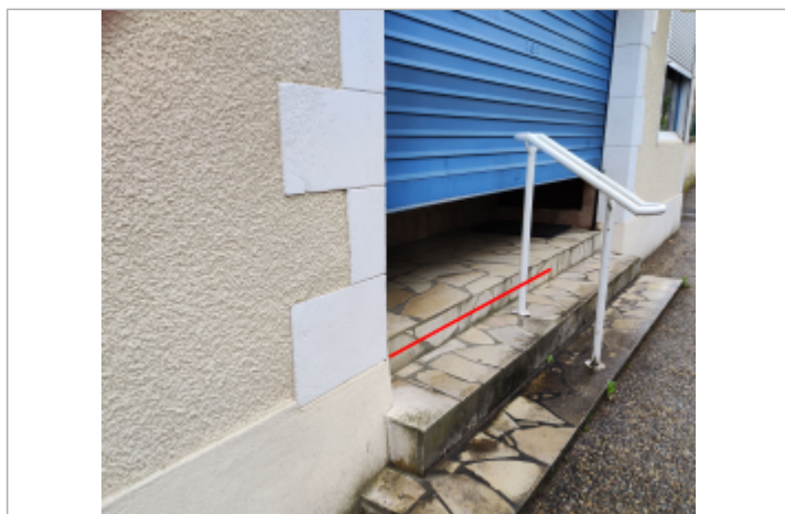
Vue du repère (le trait rouge représente le niveau atteint par les eaux) - Auteur : SMBGP
