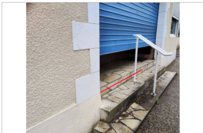
Vue du repère (le trait rouge représente le niveau atteint par les eaux) - Auteur : SMBGP
