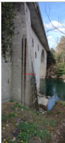
Vue du repère (le trait rouge représente le niveau atteint pas les eaux) - Auteur : SMBGP
