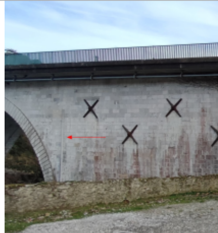
Vue du site (la flèche rouge montre l'échelle de crue) - Auteur : SMBGP
