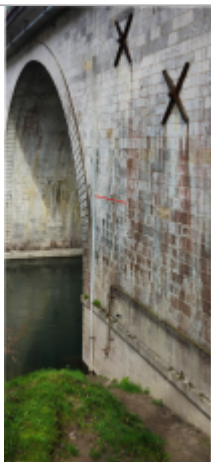
Vue du repère (le trait rouge représente le niveau atteint par les eaux) - Auteur : SMBGP
