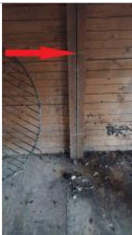
Laisse de crue sur mur en bois de la cabane à 41.5 cm/sol
