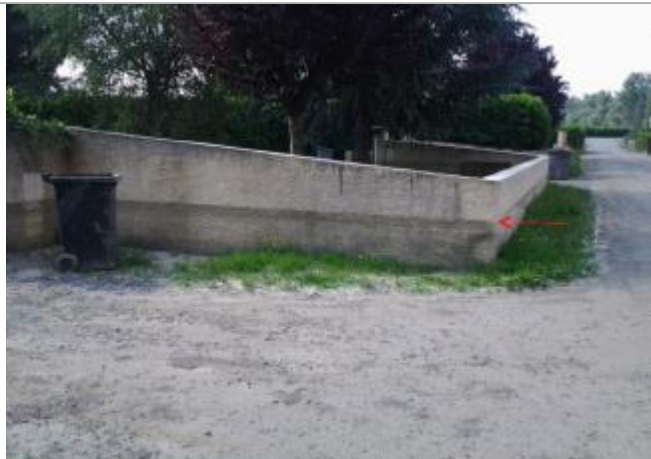
Vue du repère (la flèche représente le niveau atteint par les eaux) - Auteur : HEA/DDTM 64
